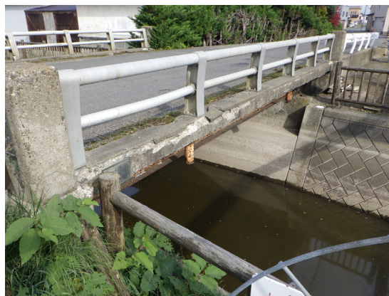
写真 3-2 凍害による損傷状況 (長橋・地覆)
