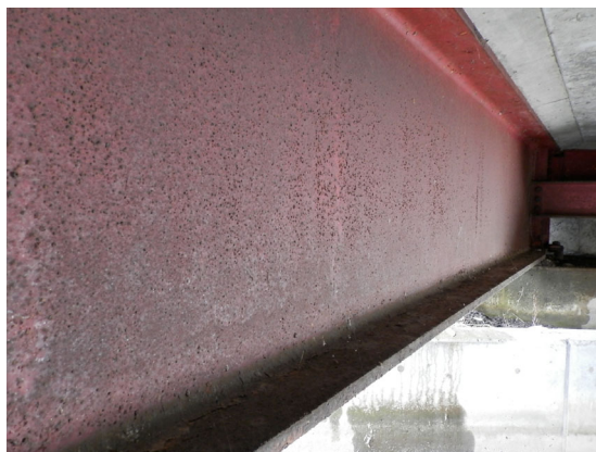
写真 3-1 塗装の損傷状況 (西俣大橋・主桁)
