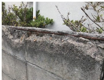
割れや鉄筋の露出がみられる塀
