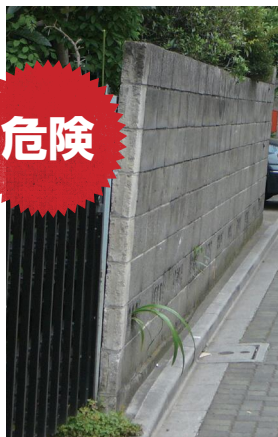
傾いている危ない塀
