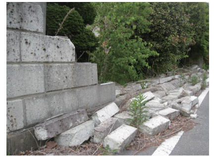
地震により石塀が倒壊
